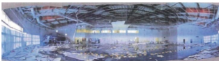
屋内プールの天井落下事故の様子
