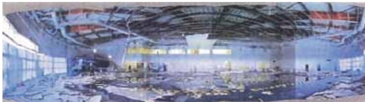
屋内プールの天井落下事故の様子
