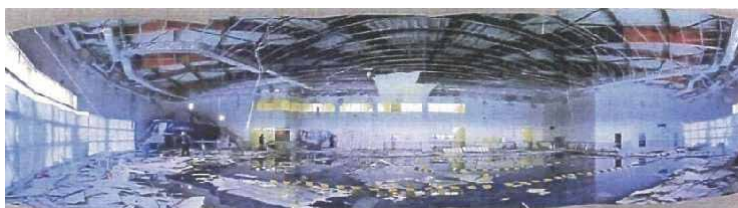
屋内プールの天井落下事故の様子
