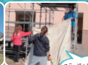
ステージの建設やテントの設置も学生を中心に行います!
